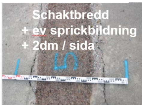
Figur 12 Bild 1 exempel på yta som ska renskäras eller sågas vid smalspårig fräsgrävning eller liknade. Bild 2 exempel på schakt med sprickor där mätning ska utgå från.
